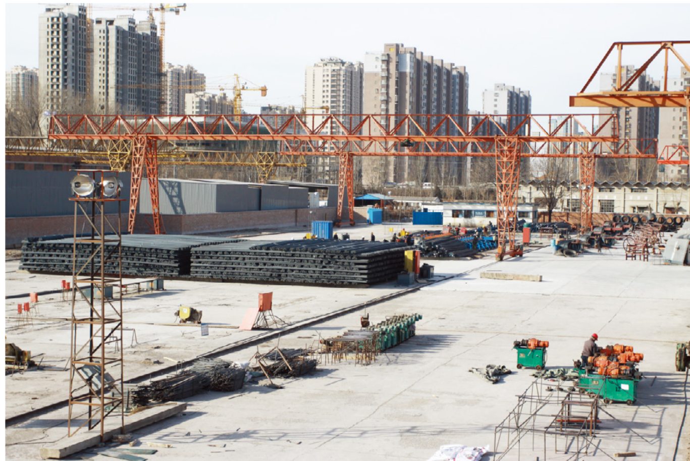
凯博钢筋自动化加工配送中心 Ready-made Reinforcement Production & Delivery Center of CABR/M
